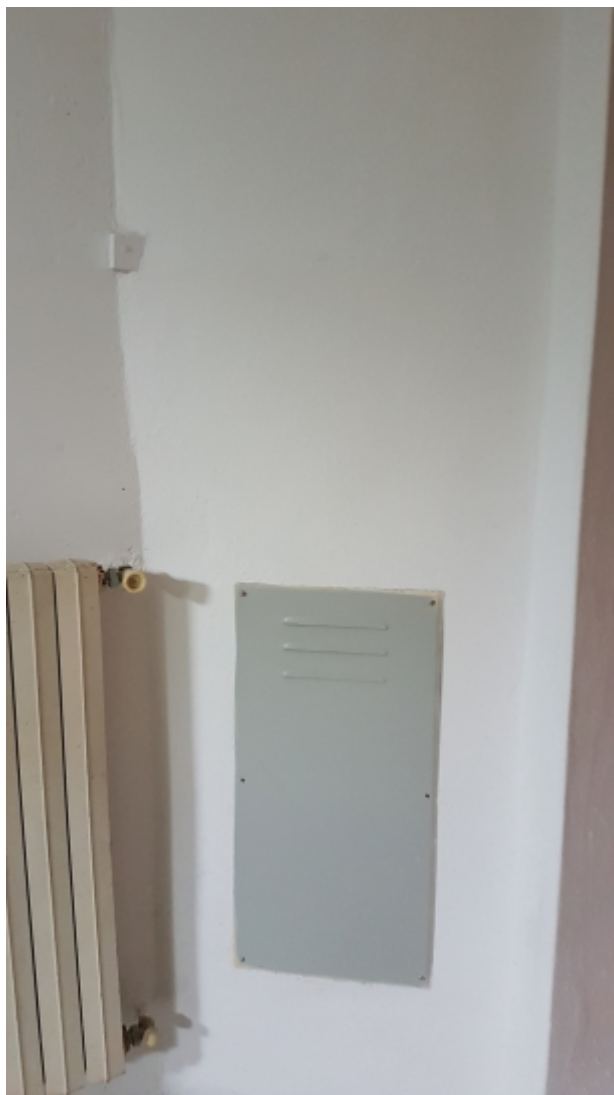
foto 4. dettaglio centralina impianto
