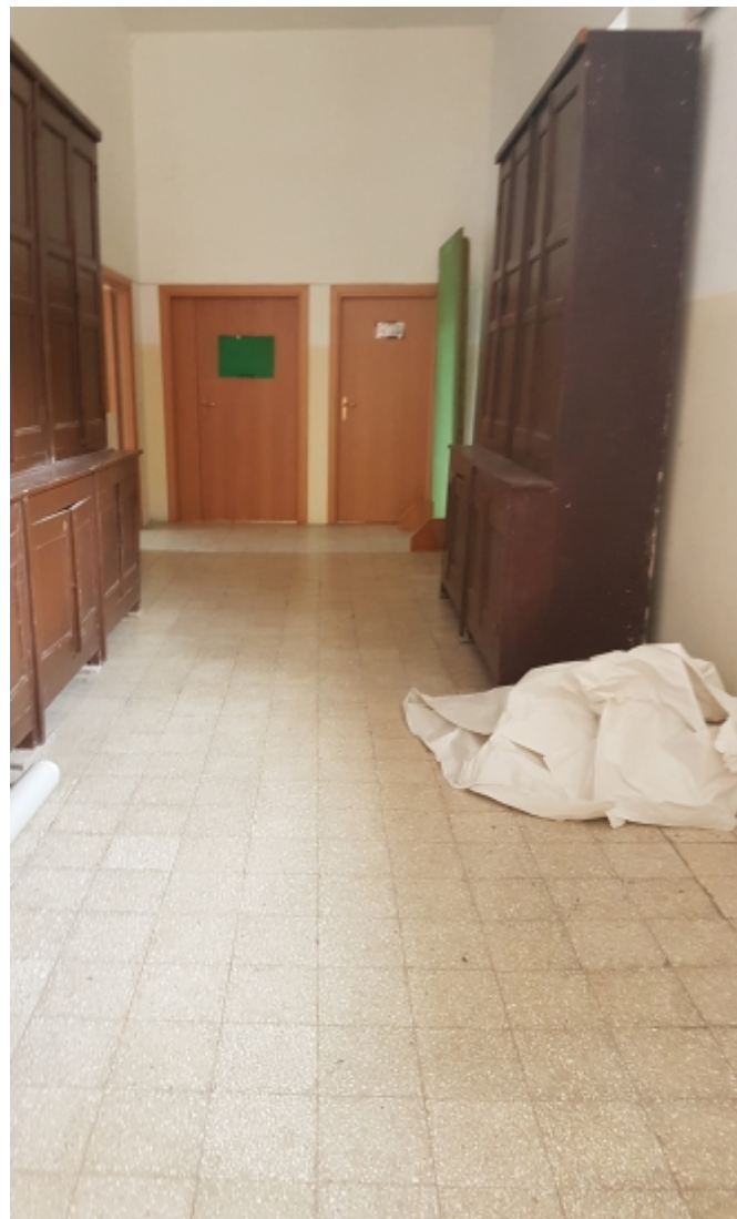
foto 5. andito con pavimentazione da sostituire
