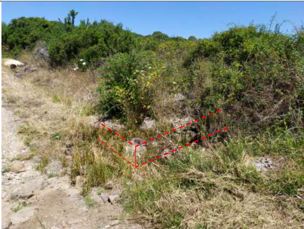
Scatto 2 – Protezioni spondali da risistemare
