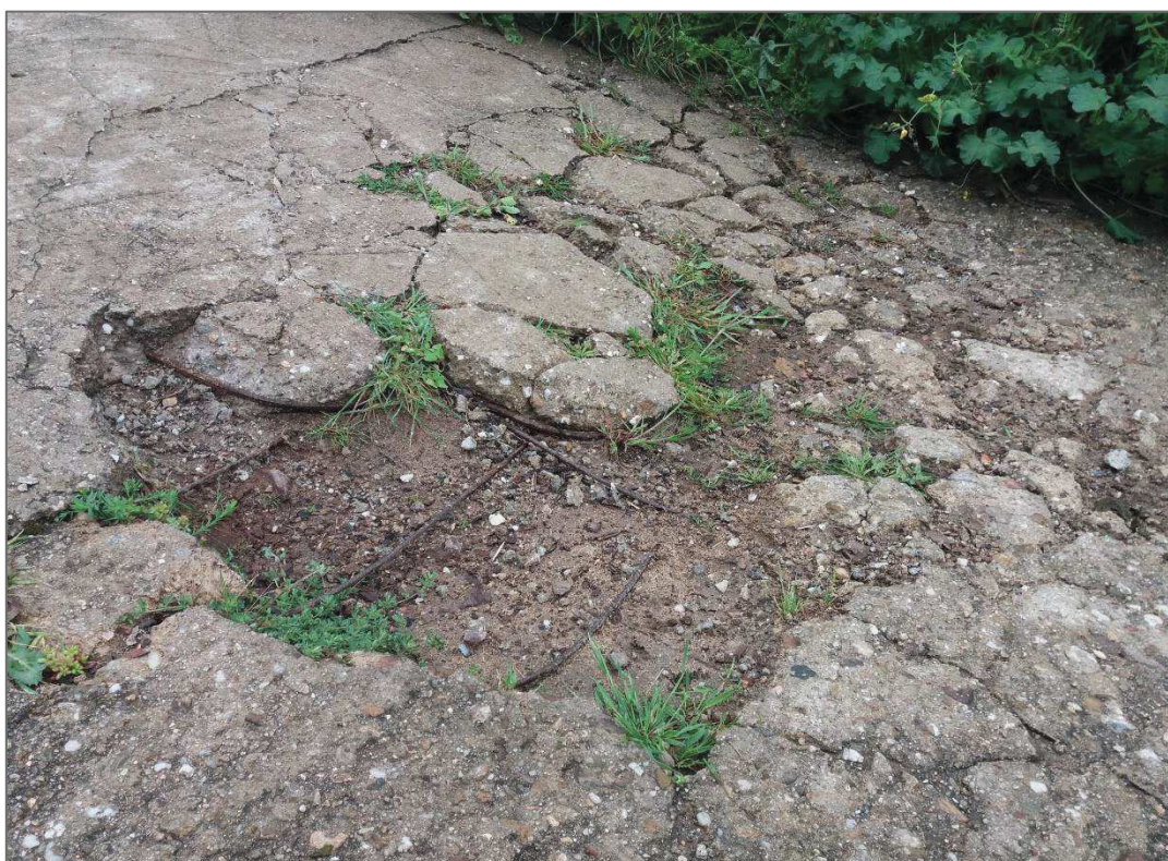
Figura 5_Dettaglio del dissesto della pavimentazione in conglomerato cementizio armato
