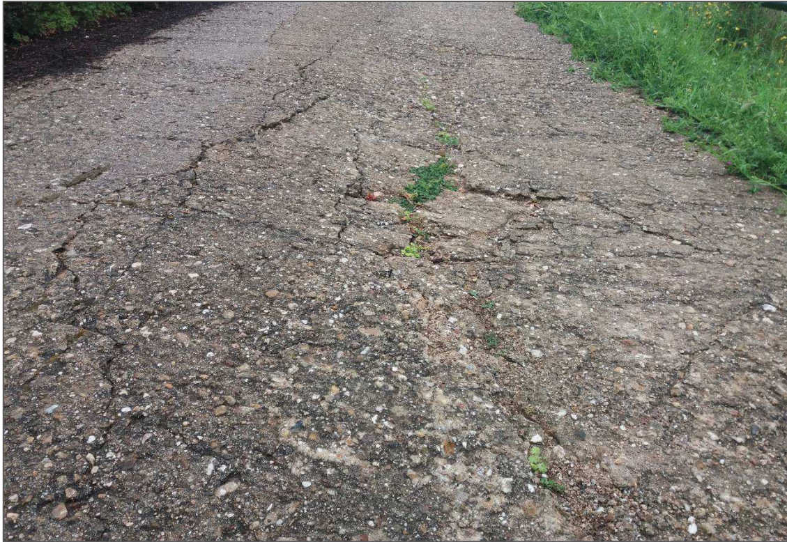
Figura 6_Altra area della pavimentazione in c.a. interessata da dissesto
